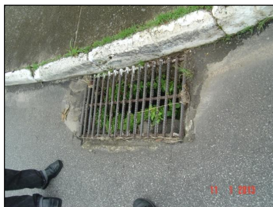
Figura 18 – Sistema de drenagem – Boca de Lobo.
