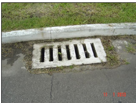
Figura 17 – Sistema de drenagem - Boca de Lobo.
